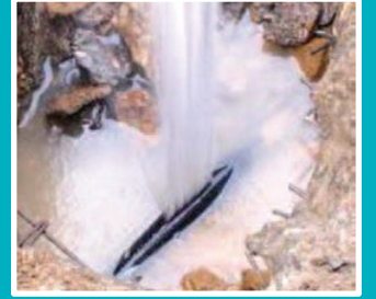
Uzunlamasına bir çatlaktan dışarı su sızıyor.
